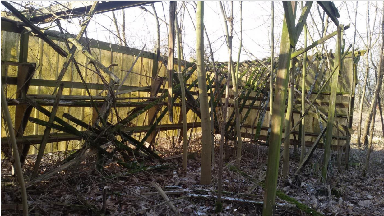
Gehölzaufwuchs im Bereich des baufälligen Schuppens wurde entfernt, da in den Zwischenräumen nicht sondiert werden kann (27.02.2018).
