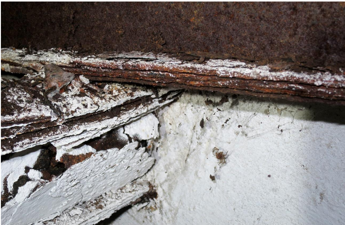
Der horizontale Stahlträger ist im Auflagerbereich praktisch vollständig korrodiert.
