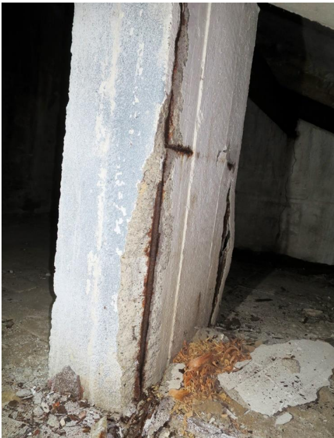
Stütze mit stark korrodierter Bewehrung
