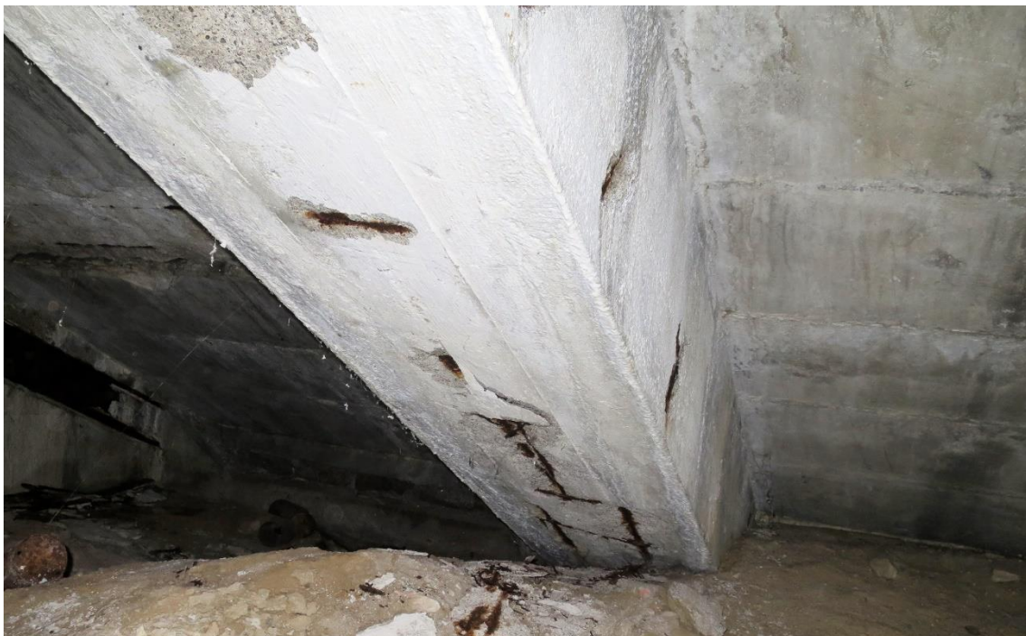
Mittelträger mit Bewehrung die teilweise frei liegt und stark korrodiert ist.
