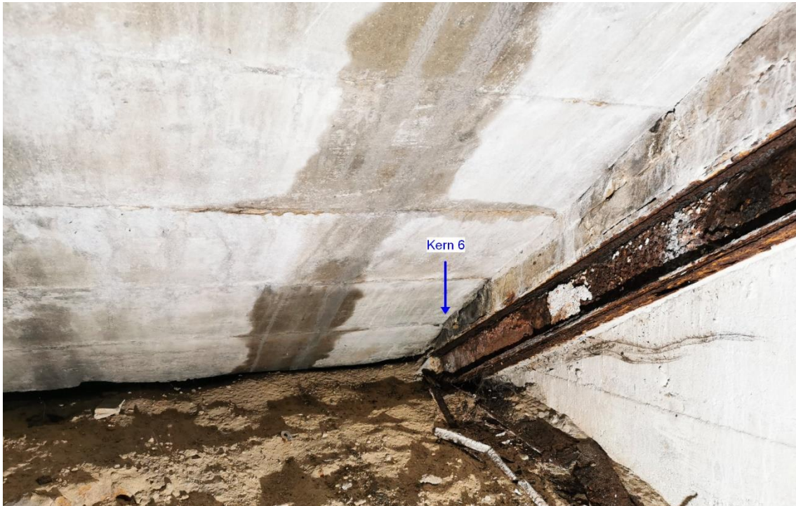
Auch der schräglauende Träger ist weitgehend durch korrodiert. Der Pfeil bezeichnet die Lage vom Bohrkern 6, der von oben durch die Betonplatte genommen wurde.
