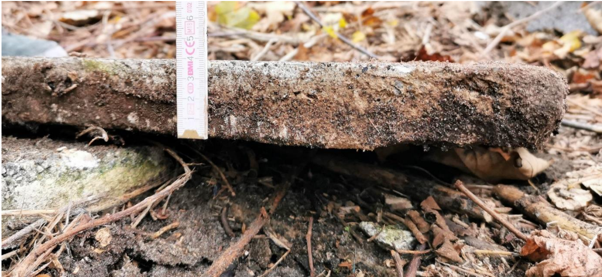
Seitliche Ansicht einer Beton- Werksteinplatte (Kunststein) vom nördlichen unteren Podest
