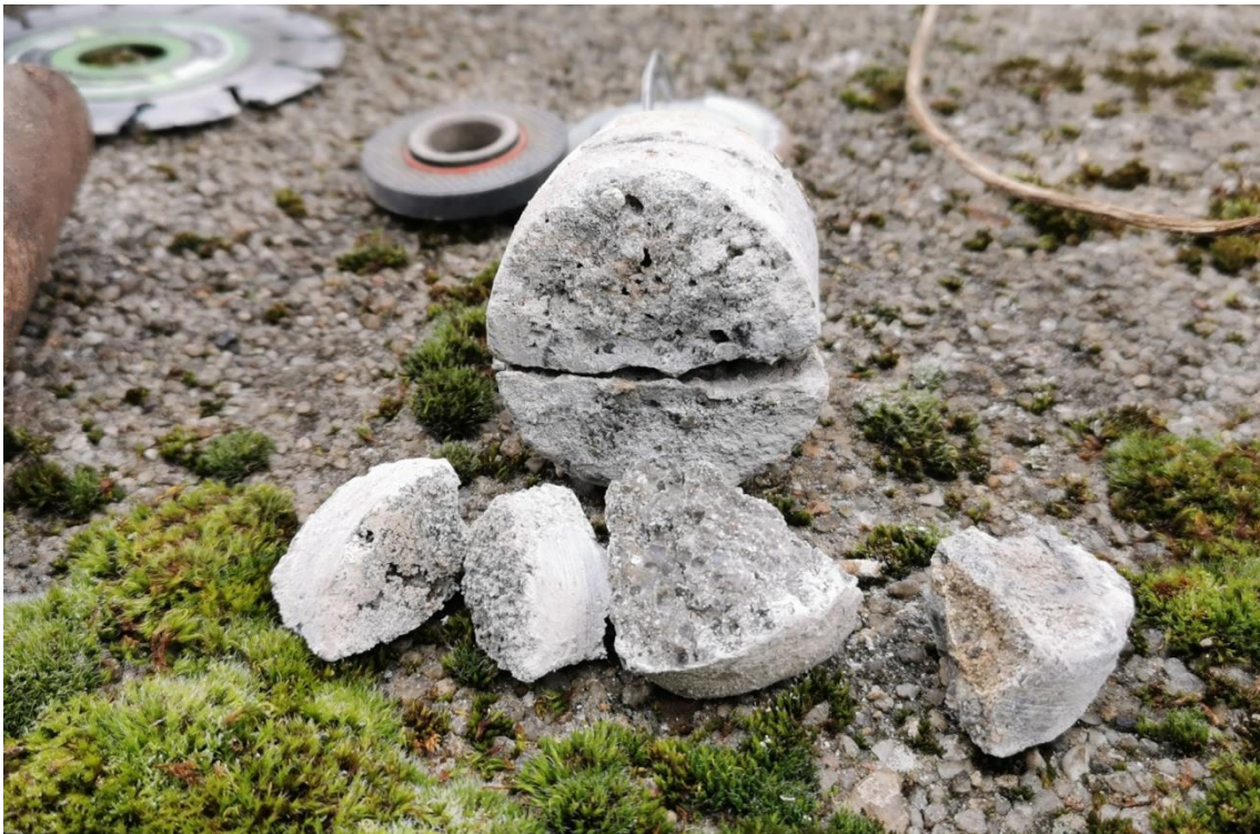
M6/ der Bohrkern ist bis in 8 cm Tiefe gerissen.
