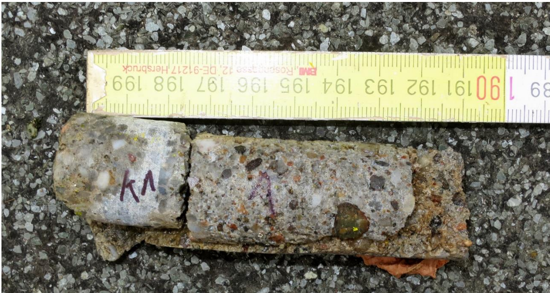
M1/ Der horizontale Riss geht durch die gesamte Treppenwange.
