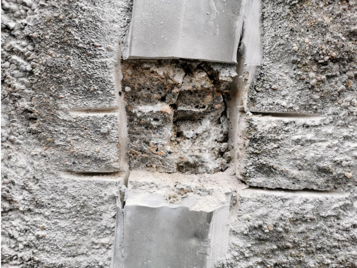
M5/ Der vertikale Riss unter dem Kunststoffband reicht wahrscheinlich durch das gesamte Bauteil.
