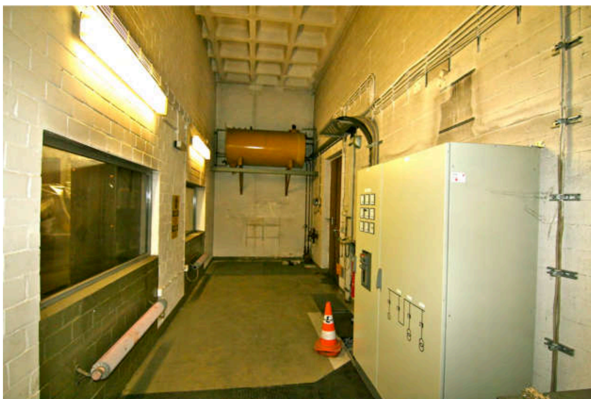
Raum 1, Schalraum. Blick nach Süden. Links Fenster F10/11 nach Maschinenraum, 2016.
