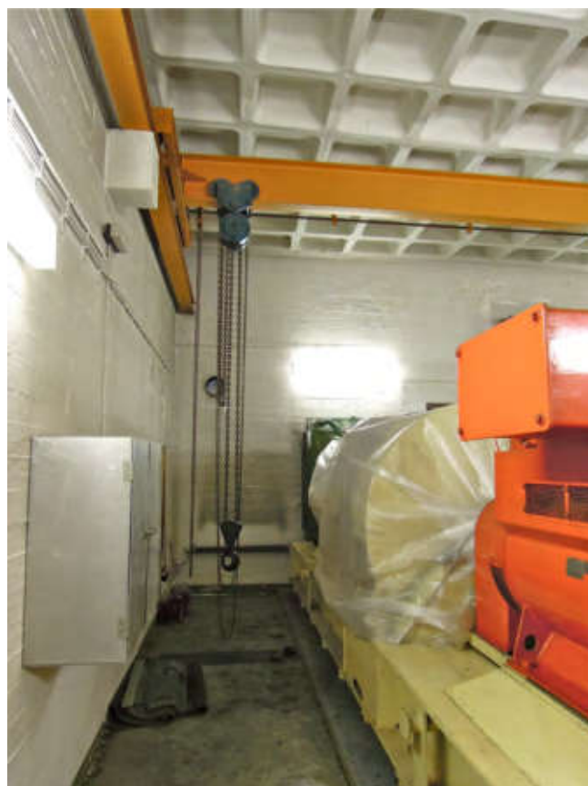
Raum 2, Maschinenraum. Kranbahn Tragkraft 5t., 2016.
