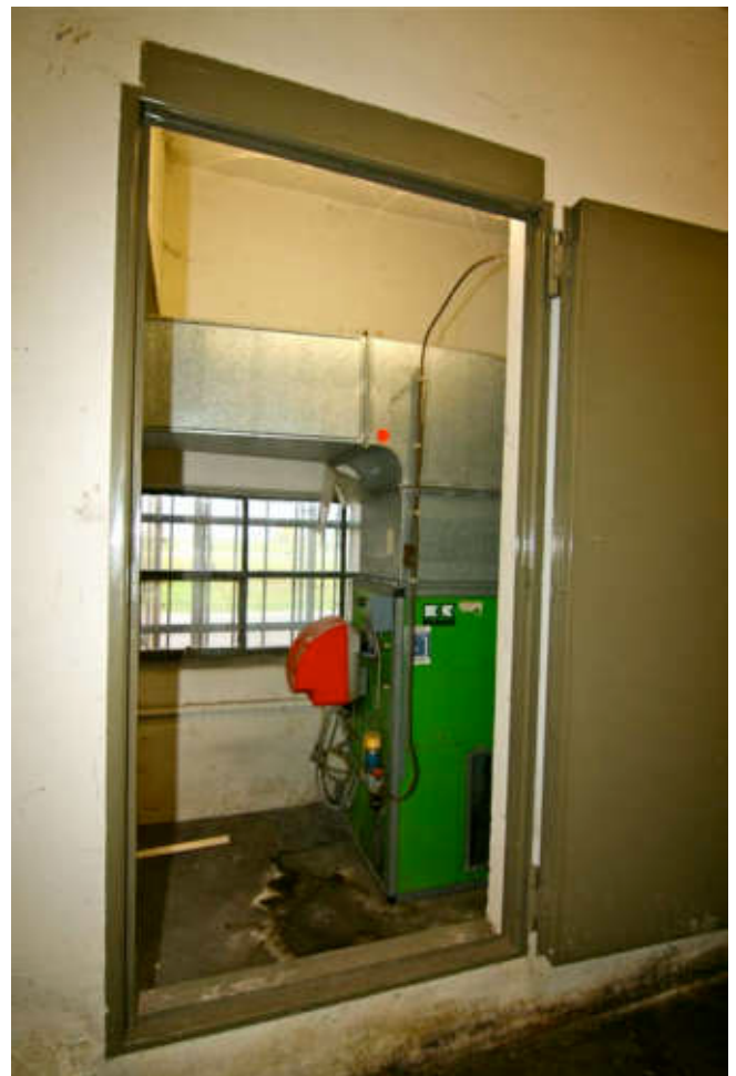
Raum 002a, Lüftungsanlage. Stahltür TI 1.
