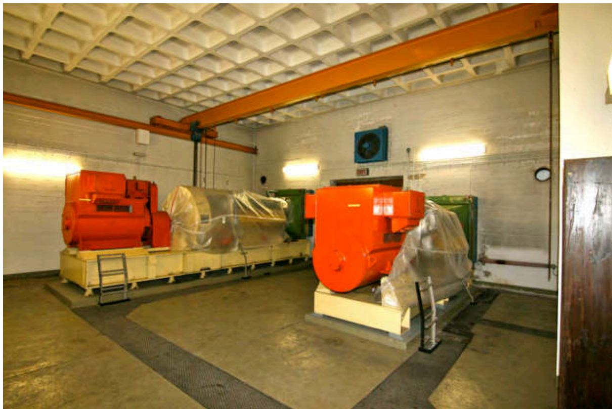
Raum 2, Maschinenraum. Hintergrund Schnellbereitschafts-Generator, Vordergrund Notstrom-Generator. 2016.
