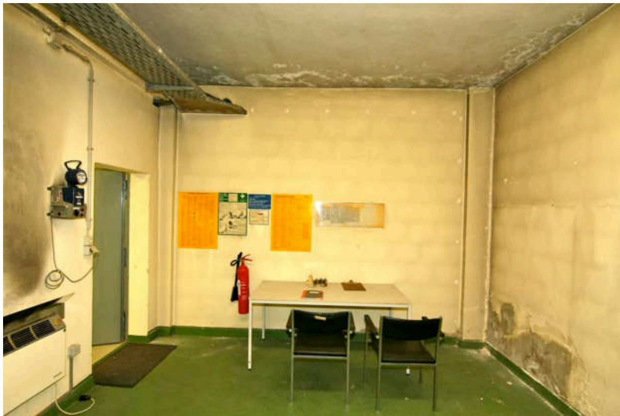
Raum 019-021, Raum zur Trafostation 21a und 21b. Links Stahltür TI 10.
