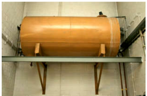
Tages-Dieseltank im Schaltraum (1) Westwand.
