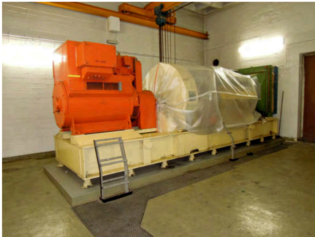
Raum 2, Maschinenraum. Schnellbereitschaftsaggregat. 2016. Fußboden mit Kabelkanal.
