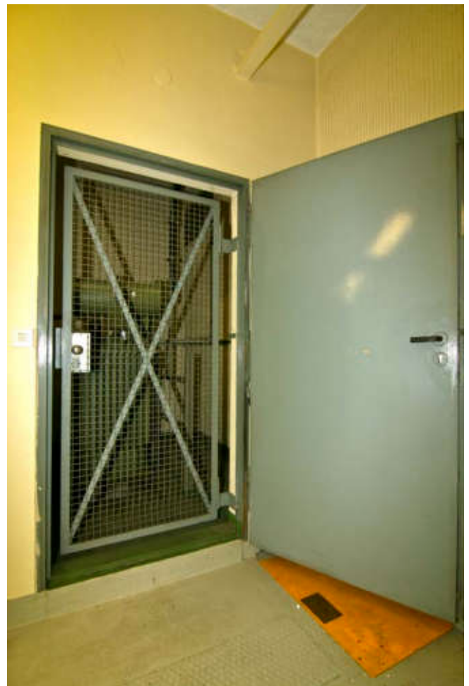
Raum 022. Hochspannungstrafo 21b. Stahltür TI 9.
