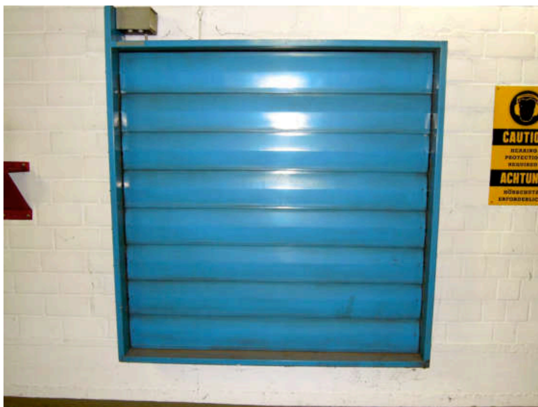
Raum 2, Maschinenraum. Zuluftlamellenfenster F8, motorgesteuert. 2016.
