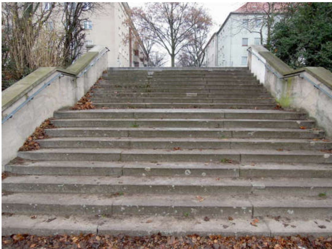
Treppenlauf mit Ausbesserungen.
