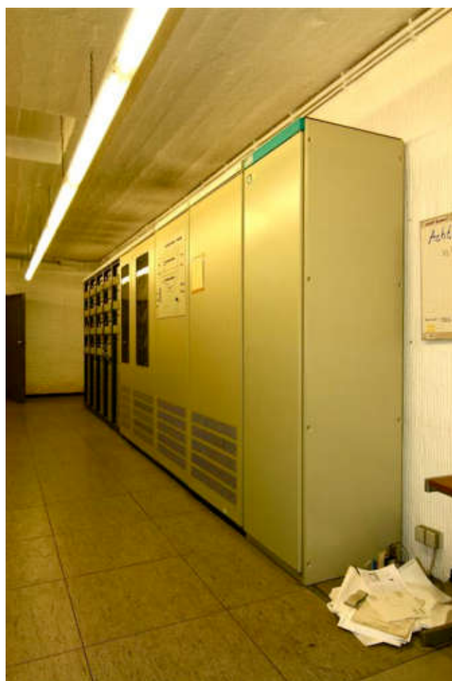
Raum 003-004, Siemens Schaltanlage für die Befuerung der Lande- und Startbahnen.
