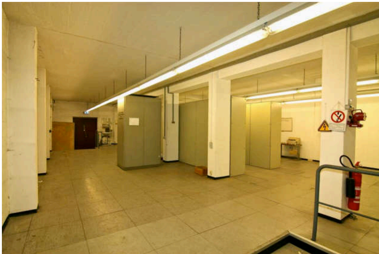
Raum 003-014, Schaltraum Befeuerung der Start- und Landebahnen. Blick nach Norden.
