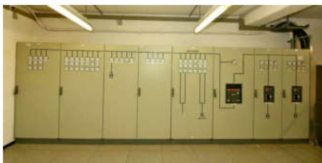
Trafo- Schaltraum Südwand. Einspeisung- und Umspannung.
