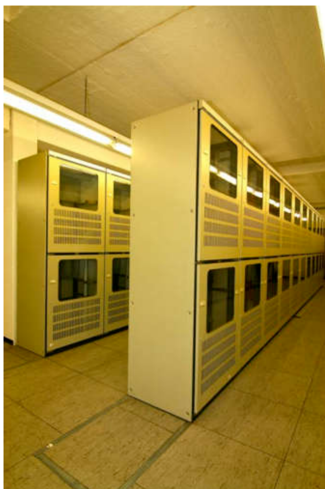
Raum 003-004, Siemens-Einzeltrafos für die Niederspannungs-Befuerung der Lande- und Startbahnen.
