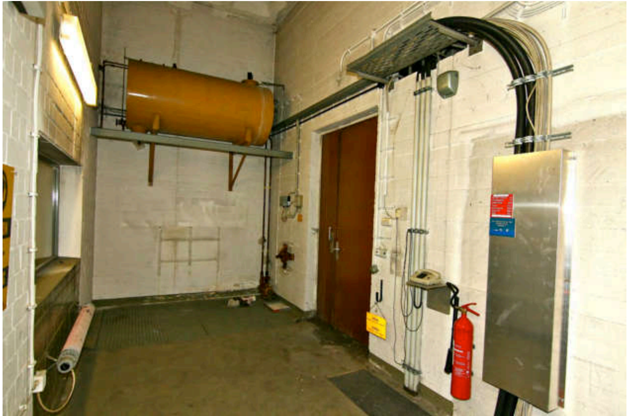
Raum 1, Schalraum. Blick auf den Tagesdieseltank. Rechts Eingang TA 1, 2016.
