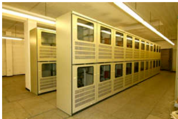
Trafo- und Schaltraum. Einzeltrafos.
