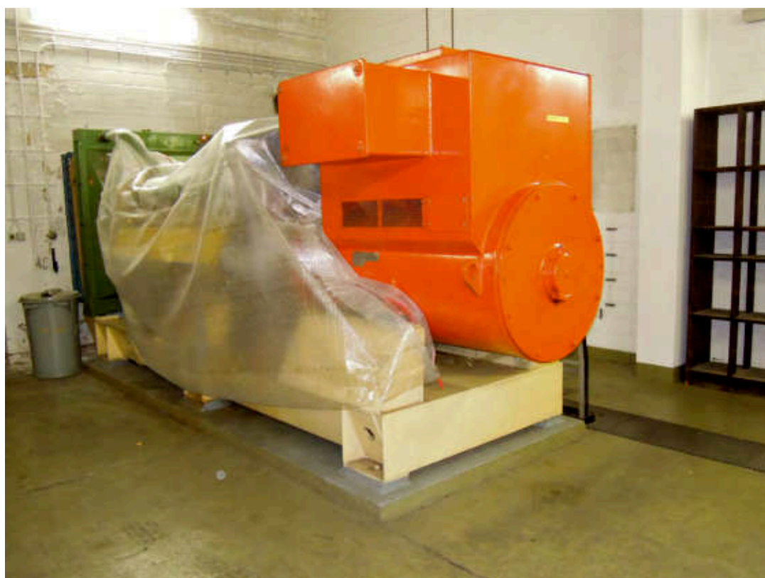
Raum 2, Maschinenraum. Notstromaggregat. 2016.
