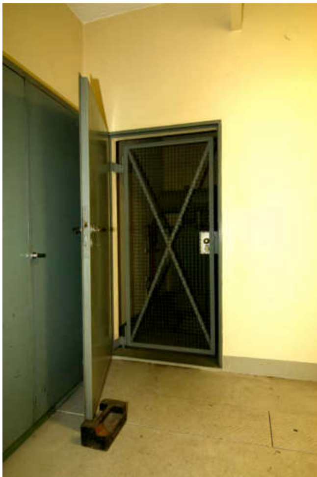
Raum 018. Hochspannungstrafo 21a. Stahltür TI 7.
