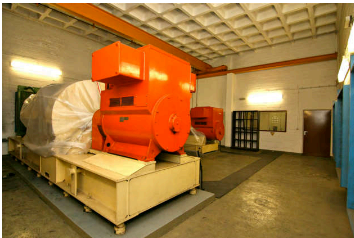
Raum 2, Maschinenraum. Vordergrund Schnellbereitschafts-Generator, Hintergrund Notstrom-Generator, rechts TI 1. 2016.
