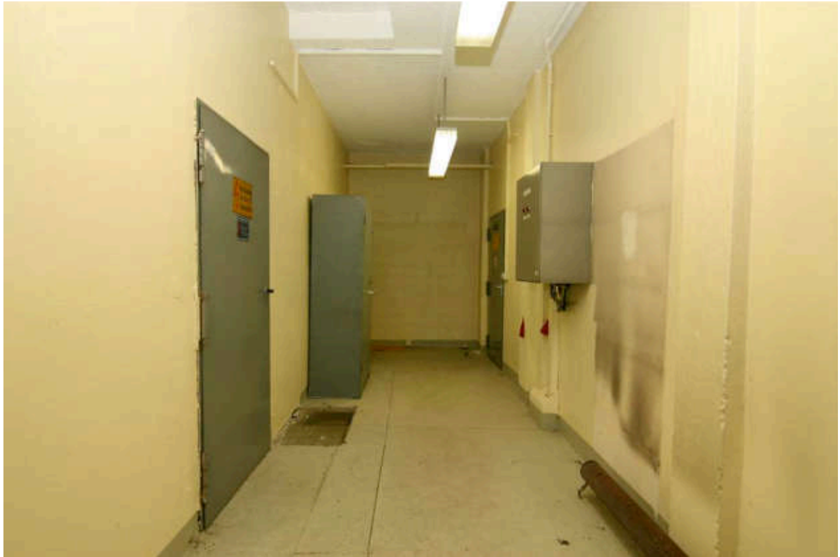
Raum 018a-022a, Flur. Blick nach Süden. Links Stahltür TI 8 nach Hochspannungsraum 020.
