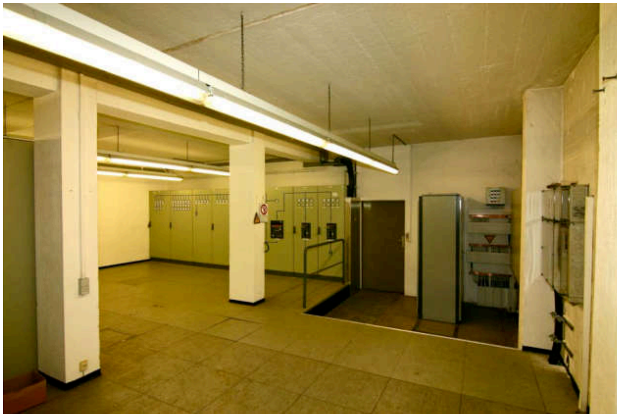
Raum 003-014, Schaltraum Befuerung der Start- und Landebahnen. Südwand mit Stahltür TI 2.
