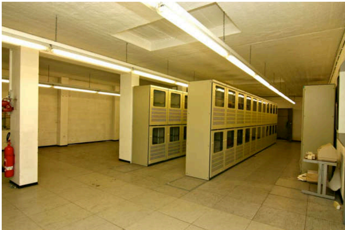
Raum 003-014, Schaltraum Befeuerung der Start- und Landebahnen. Einzeltrafos zur Steuerung der Flugfeldleuchten.
