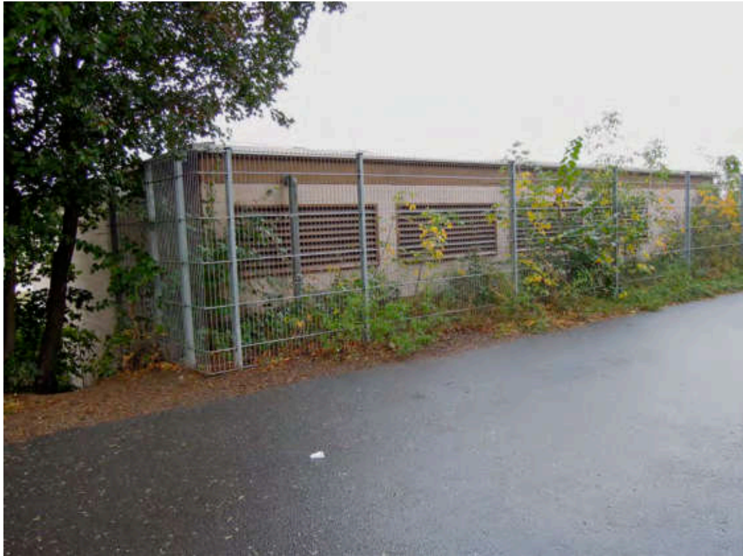
Ostfassade an der Oderstraße, 2016. Zuluft-Lamellenfenster F3 bis F6.
