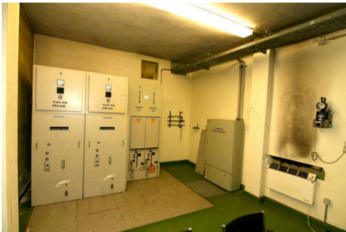
Raum 019-021, Raum zur Trafostation 21a und 21b.
