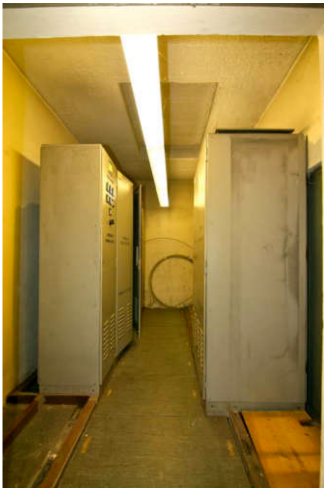
Raum R016, Schaltanlage Nordbahn.
