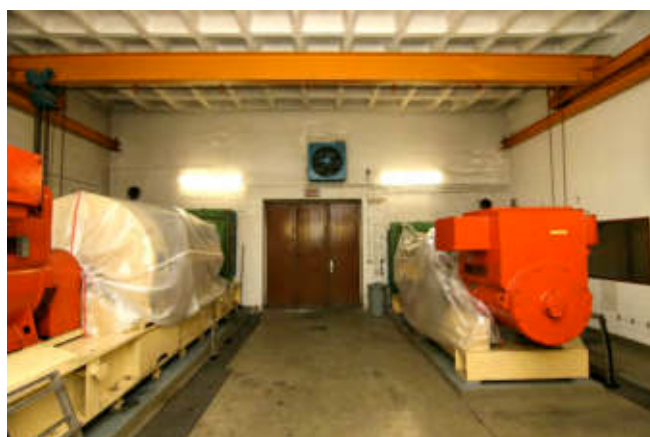
Raum 2, Maschinenraum. Kranbahn Tragkraft 5t., 2016.
