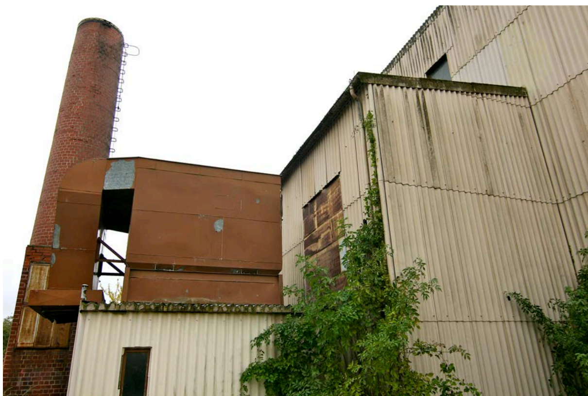
Südseite. Getrennte Verbindungen Ofen-Entstaubungsanlage.
