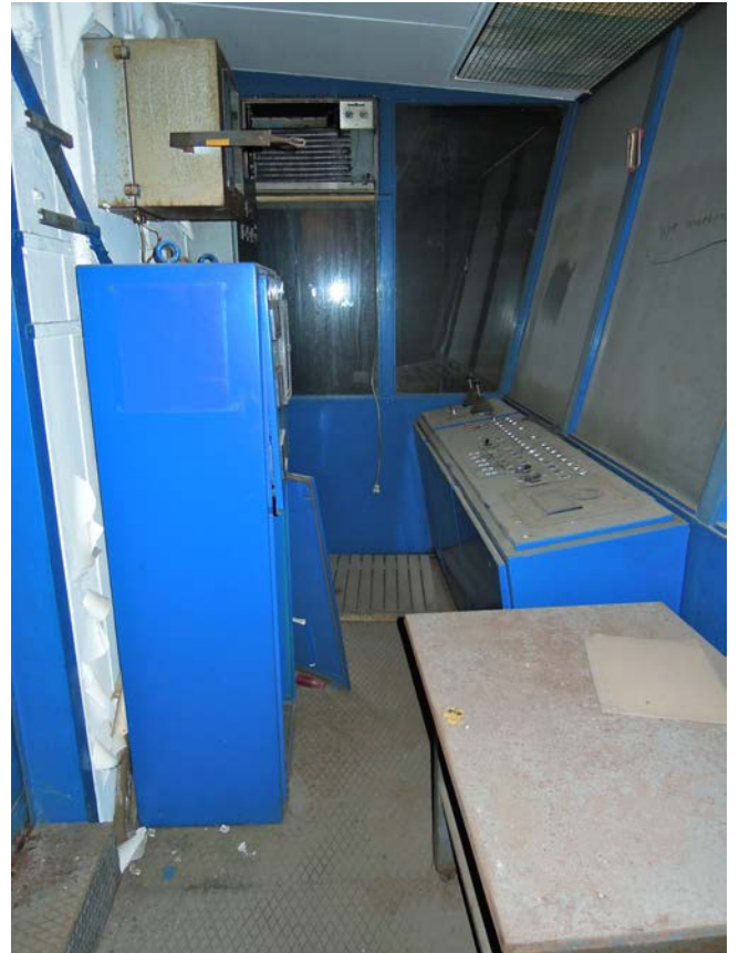
Arbeitsbühne Ebene 3. Schaltwarte, Schaltpult.
