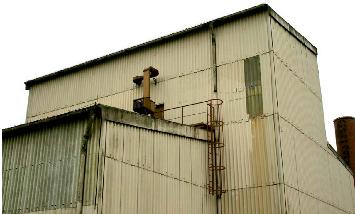
Westseite. Notausstieg Schaltwarte auf das Dach, Teil der abgebauten Abstiegsleiter mit Rückenschutz.
