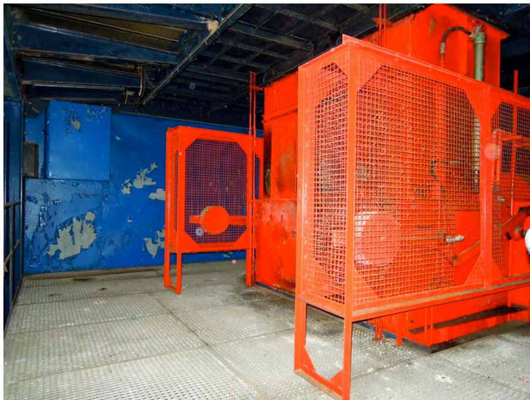
Arbeitsbühne Ebene 2. Ofen. Hydraulik-Antriebs-Aggregate (in Stahlgitterkäfigen) für die Müllbeschickung.
