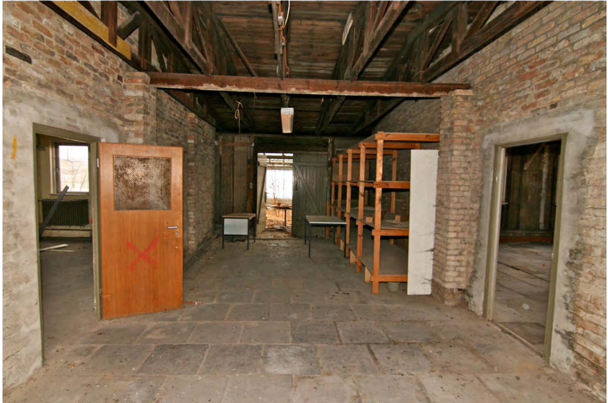
Raum 2, ehemals Lager für Kunstdünger. Blick auf Eingang TA 6 nach dem Gewächshaus. Links Tür TI 1.9.
