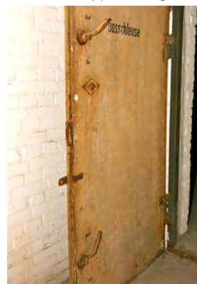
Luftschutztür TI 0.1, Verriegelung.
