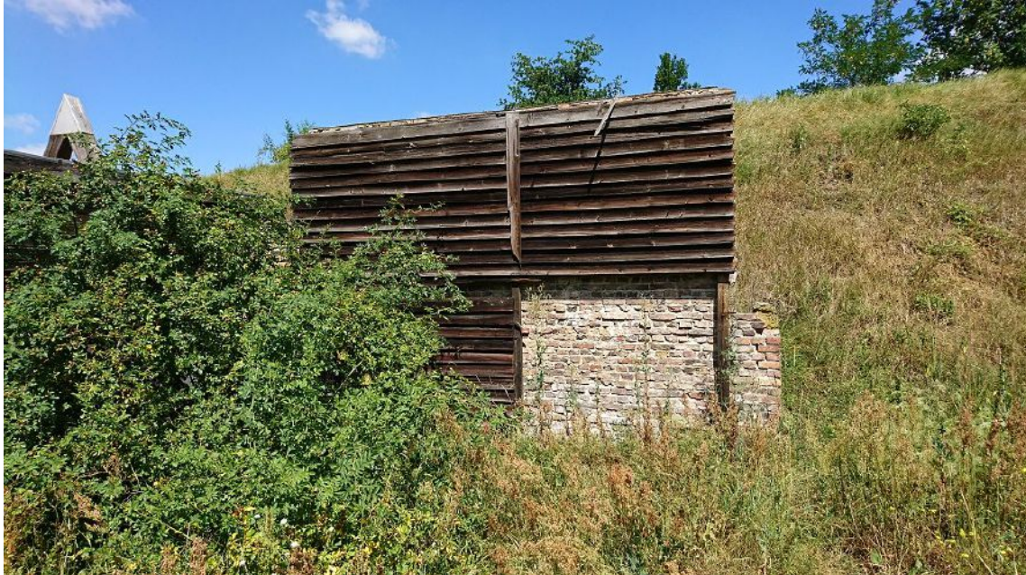
Foto. 5. Eine Schutzmauer in der ehemaligen Schiessanlage. In der Mauer unten rechts nisten verschiedene Wildbienenarten.,
